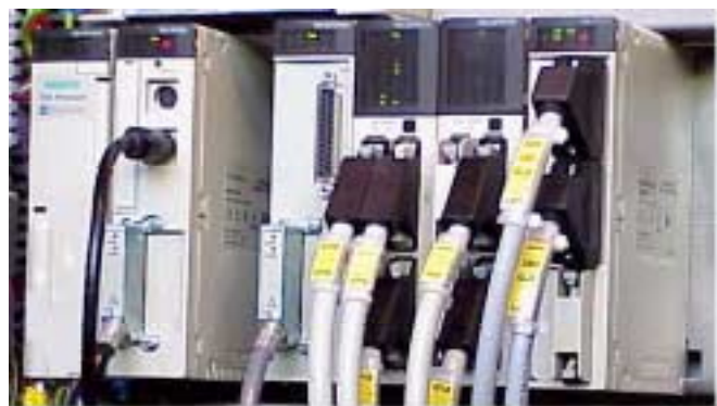
Hastière - automate de commande d'un pertuis du barrage © MET - D. 451B
