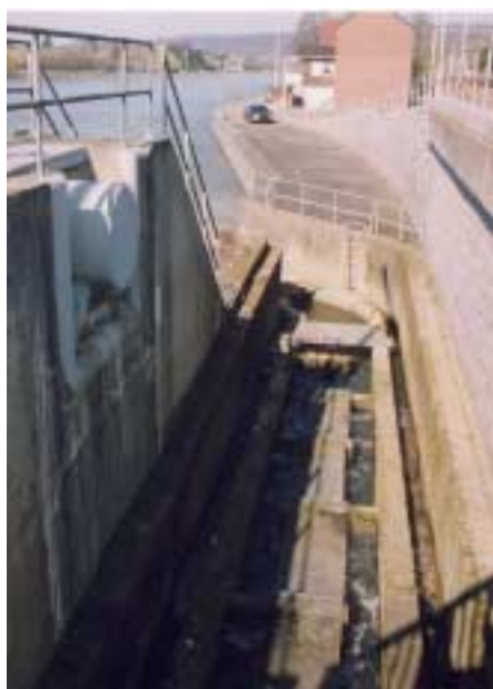
Echelle à poissons au barrage de Tailfer © MET - D. 434 – 97/00694
