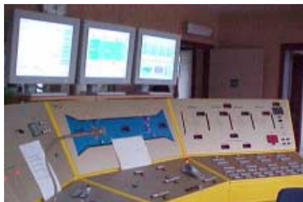
Dinant - pupitre de commande du barrage-écluse © MET - D. 451B
