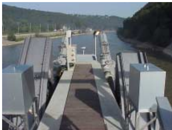
Hastière - Equipements électromécaniques © MET - D. 451B
