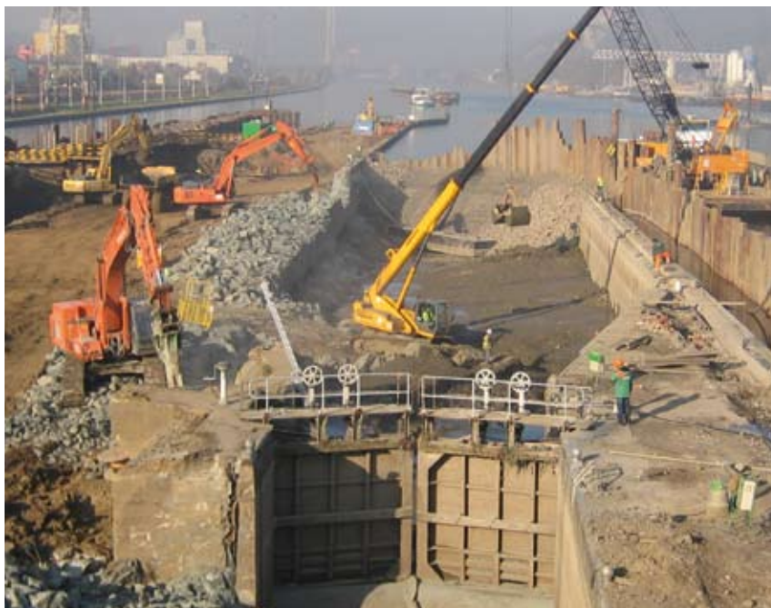
La construction d'un sas supplémentaire à l'écluse d'Ivoz-Ramet représente un investissement de 62 Mio €.
